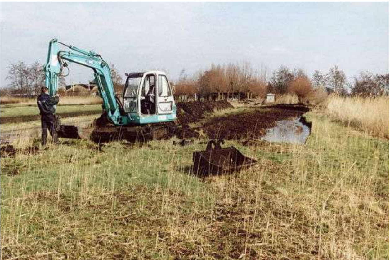
Figuur 8: Graafwerkzaamheden t.b.v. natuurbeheer kunnen een bedreiging zijn voor cultuurhistorische waarden
