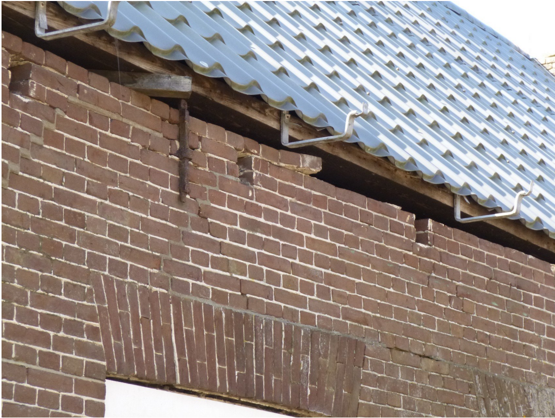
De voorgevel van de oude woning. De muur is slechte staat met scheuren en grote openingen. Foto. K. de Vries | Ecoresult BV
