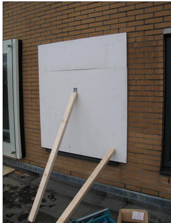
Foto II.4 Provisorische afdichting tweede raam
