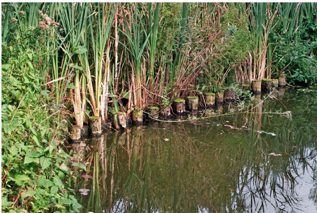
Afbeelding 40: Constructie type A: palenrij met gording en doek, achter de beschoeiing ingeplant met inheemse oeverplanten.
