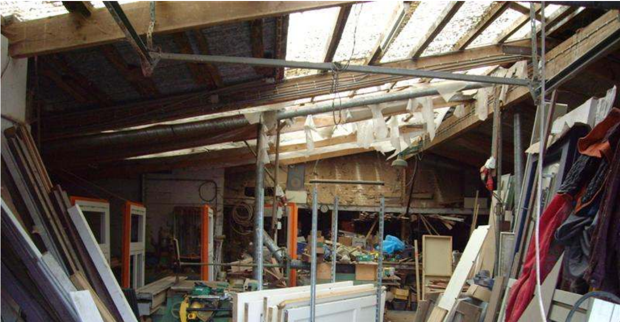
Figuur 9: interieur van de grootste schuur die afgebroken wordt. Onder de dakbedekking zijn geen kieren of holtes aangetroffen die geschikt zijn voor de Gierzwaluw, Huismus of vleermuizen.
