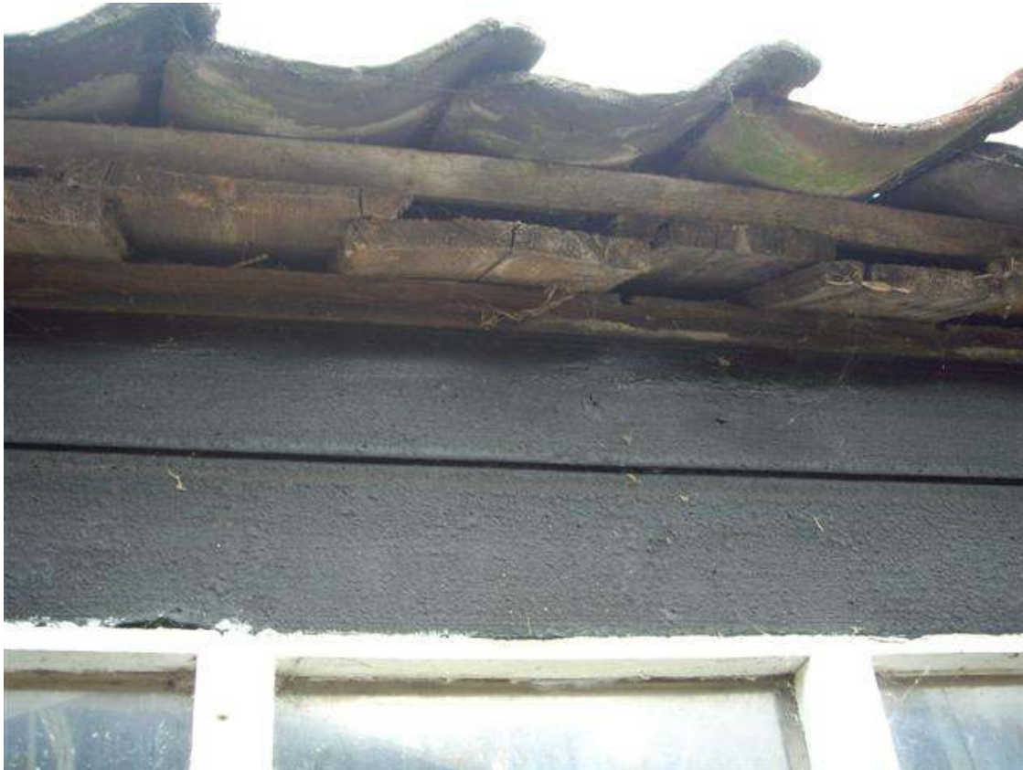
Figuur 8: Planken met kieren onder de dakbedekking van een van de houten loodsen die gehandhaafd blijven.
